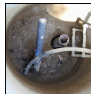
Šachtice s vyústěním tyčového extensometru se snímačem dráhy
